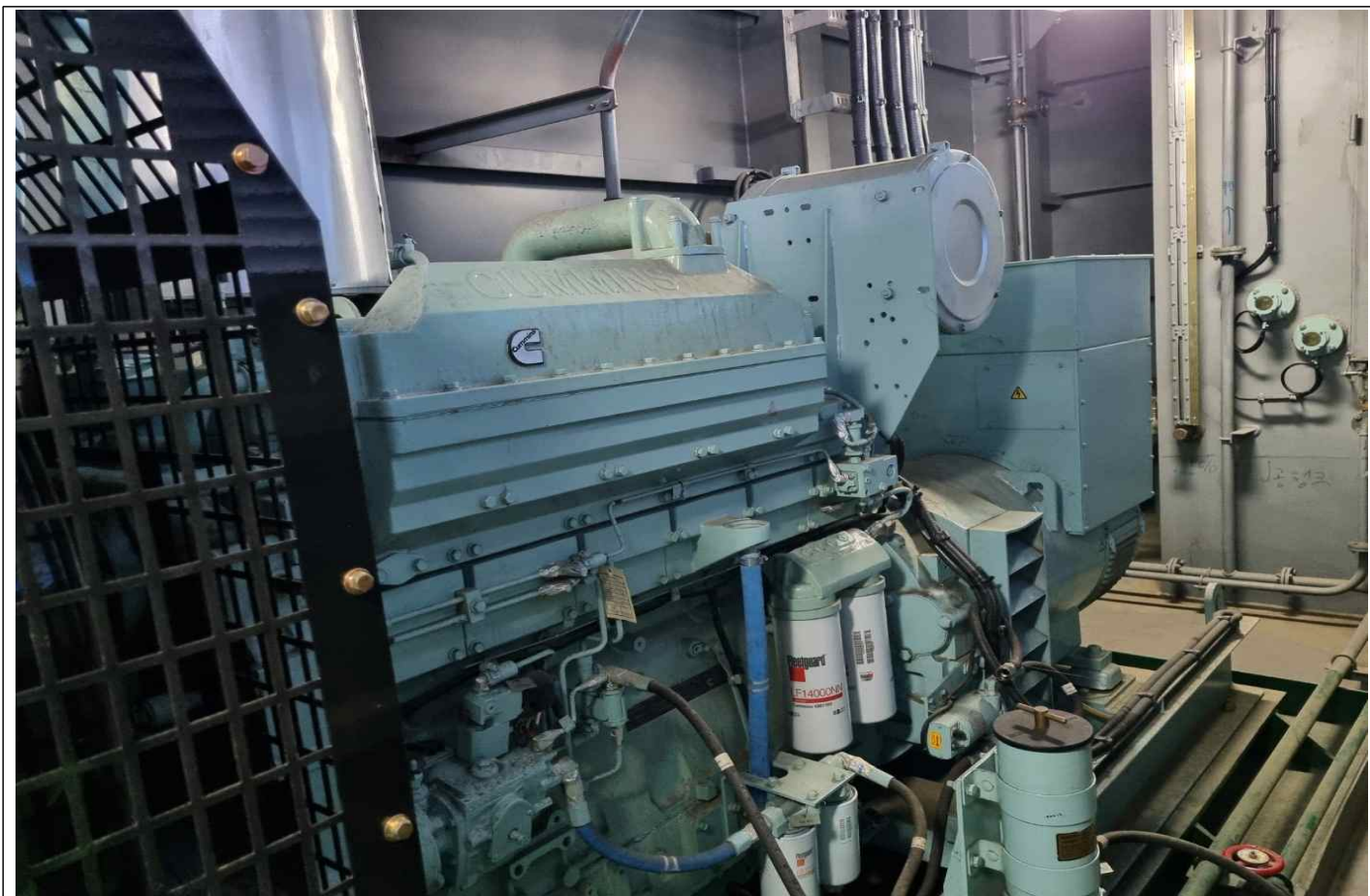
No1, No2 Generator
